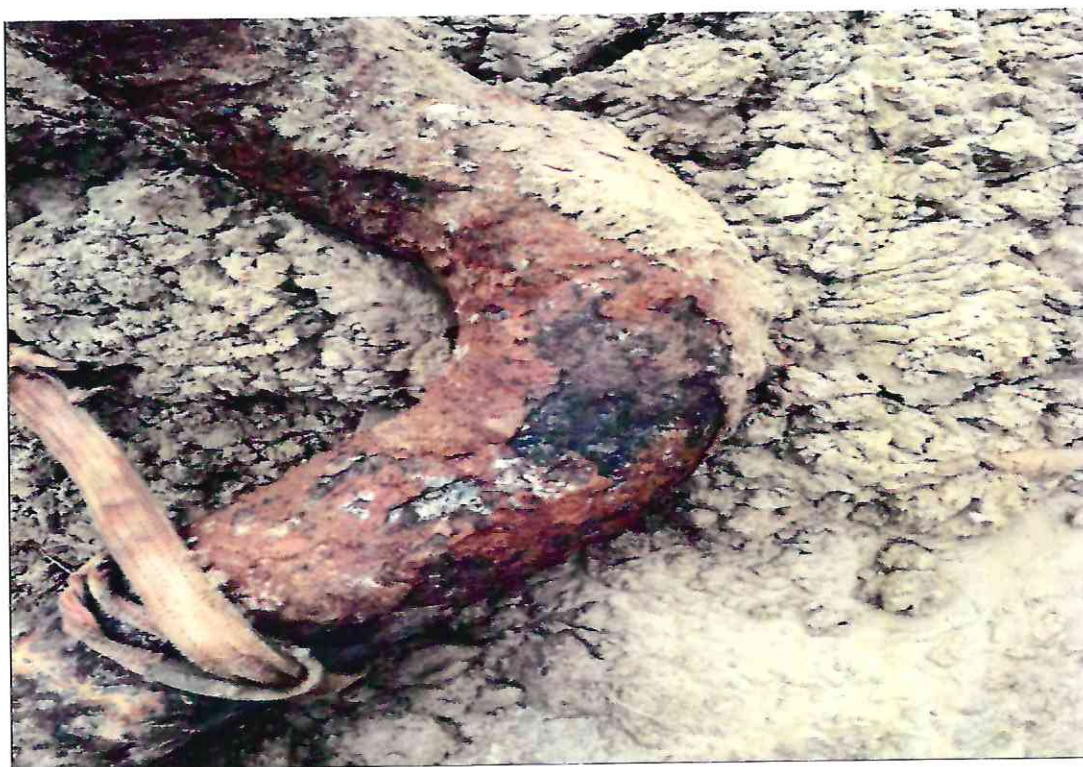
ФОТО 10 Коррозия трубопровода внутриквартальных сетей в мкр. №1
