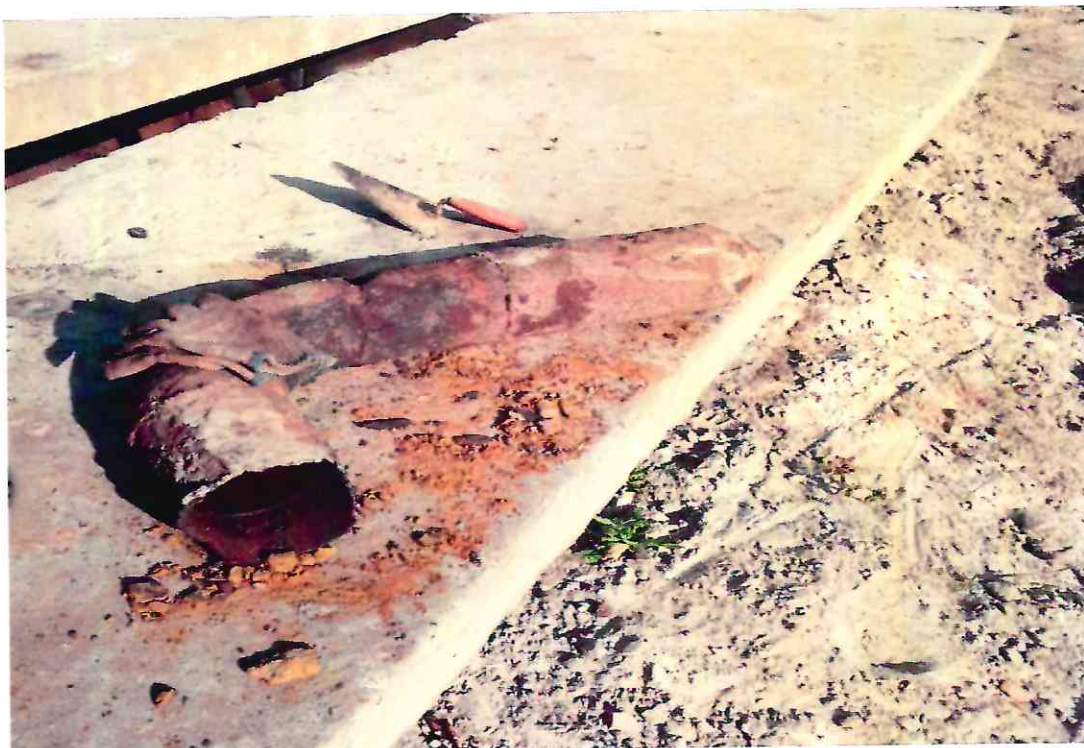
ФОТО 9 Коррозия трубопровода внутриквартальных сетей в мкр. Пионерный
