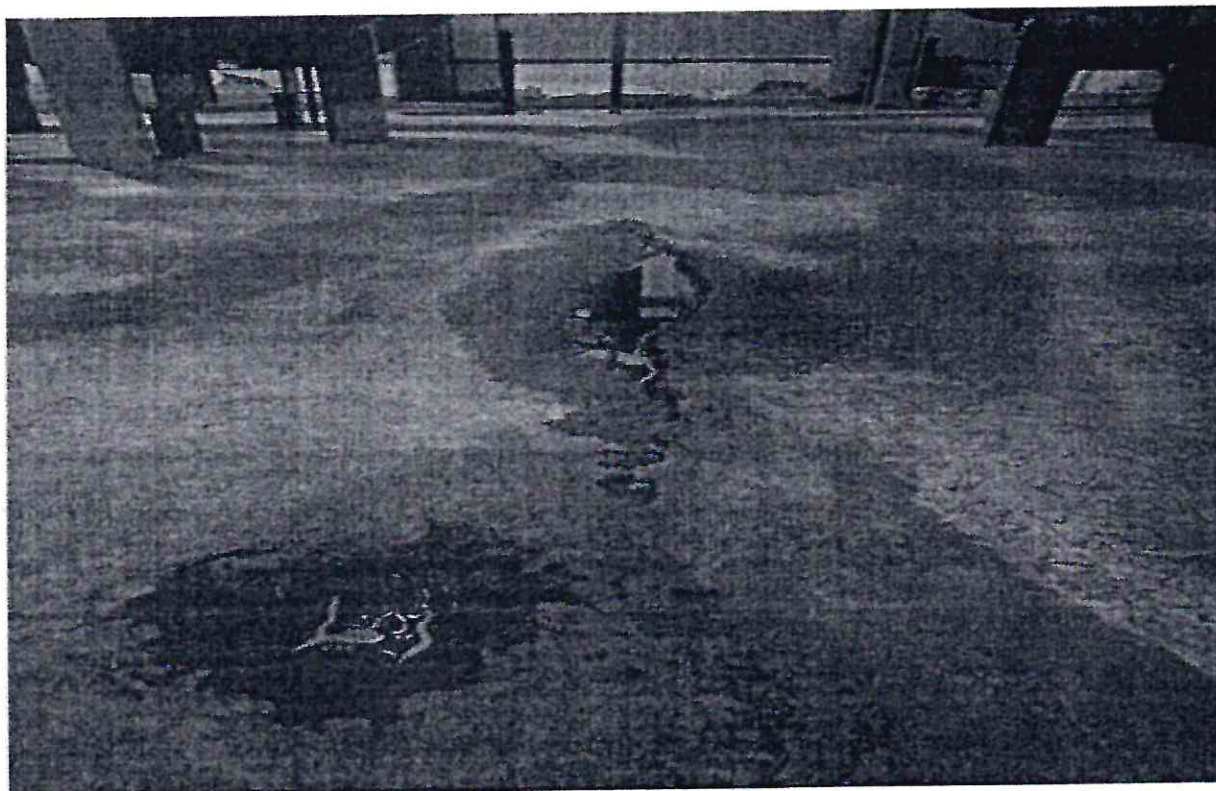
Участки нарушения целостности бетона полов здания ЦТП
